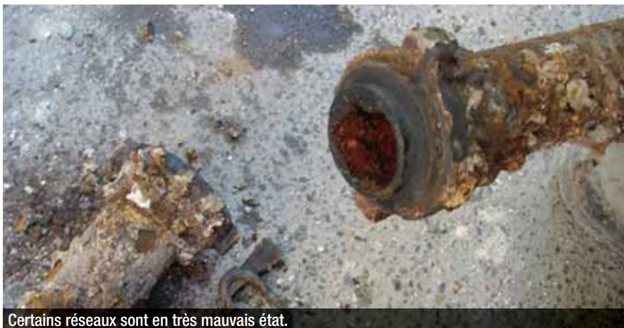
DF Certains réseaux sont en très mauvais état.
